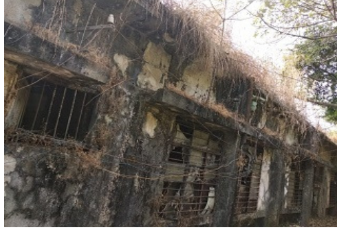
सदर थाना, राँची का भवन जिसकी तत्काल मरम्मत की आवश्यकता है (20/12/2018)।
