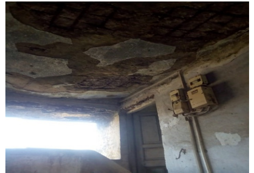
जमशेदपुर में जैप-6 में अति जर्जर भवन में संचालित पुलिस अस्पताल (28/11/2018)
